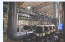
Самопромывные фильтры очистки воды. ОАО
