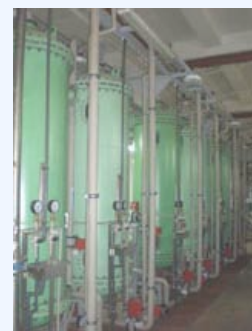
Противоточные ионообменные фильтры производительностью 12 м 3 /час. РТС «Строгино» (Москва)
