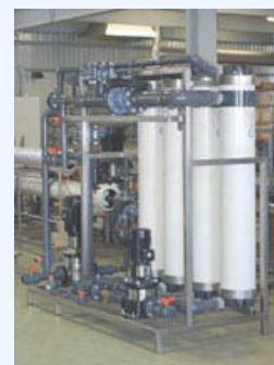
Система ультрафильтрации воды в водоподготовительной установке Ноябрьской ПГЭ
