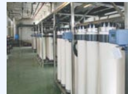
Система ультрафильтрации 260 м 3 /ч. Ставропольская ГРЭС (ОГК-2)
