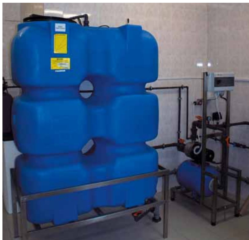
■ Накопительные емкости и насосные станции раздачи воды потребителям
